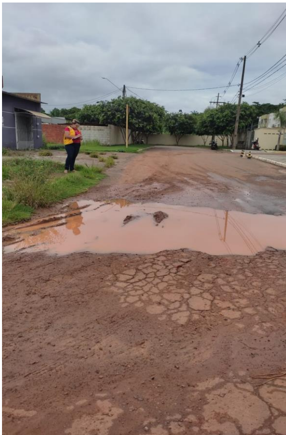
Figura 1 - Buraco em massa asfáltica.
