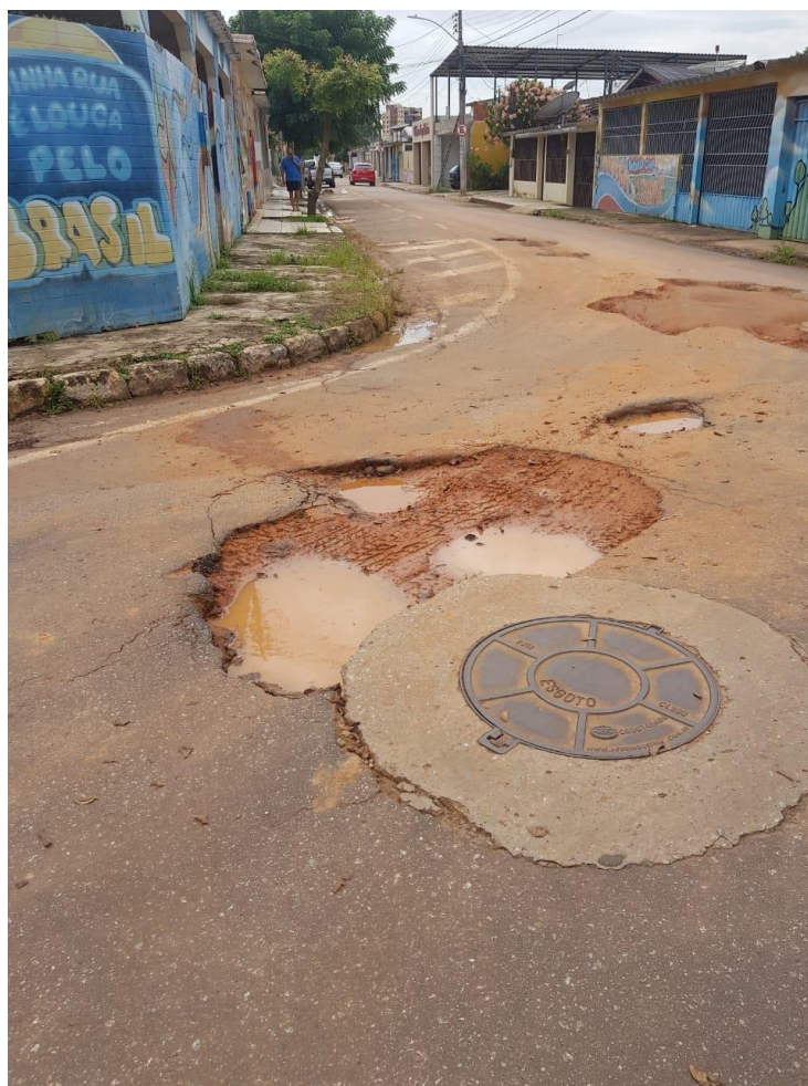
Figura 1 – Necessidade de restauração asfáltica.
