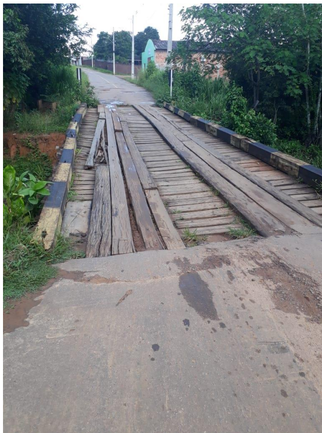
Figura 1 – Ponte precisando de reforma
