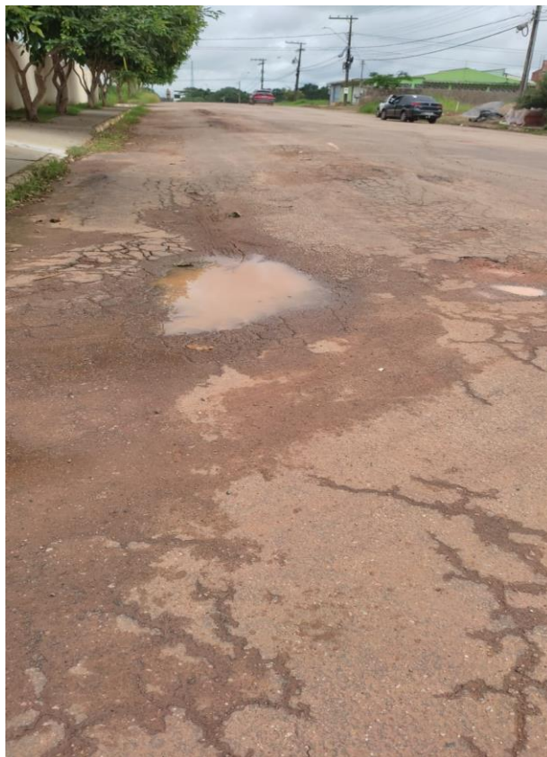
Figura 1 – Buraco em massa asfáltica.
