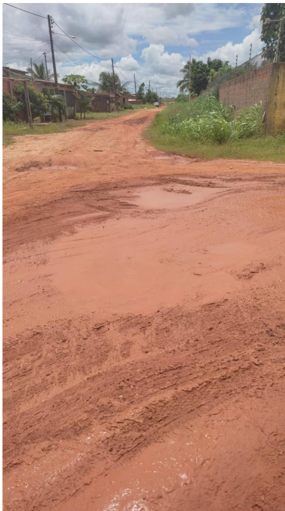
Figura 1 – Rua necessita da pavimentação asfáltica
