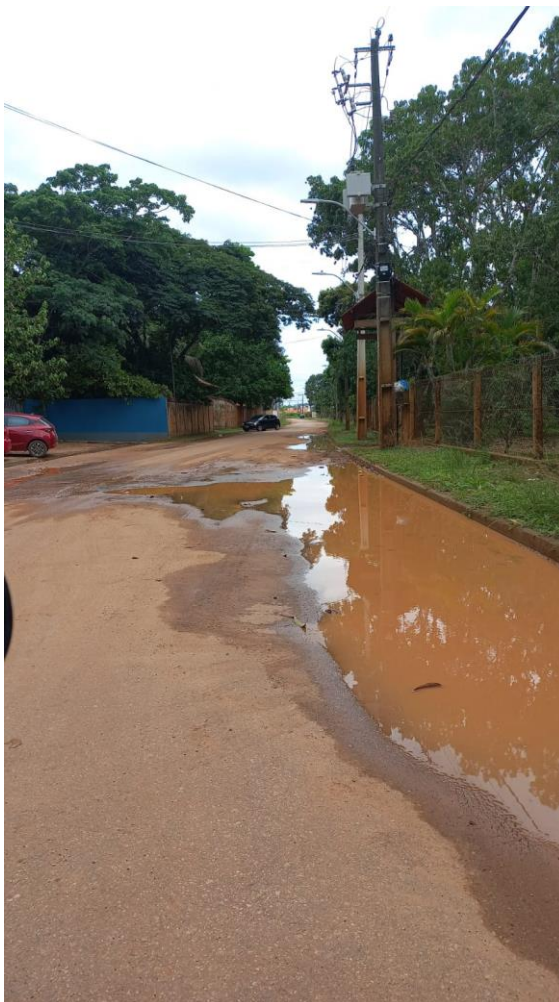
Figura 1 – Depreciação Massa asfáltica .
