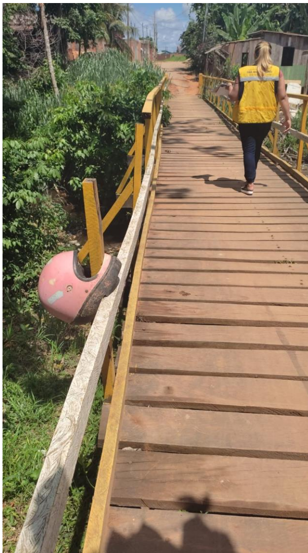
Figura 1 – passarela precisando de reforma
