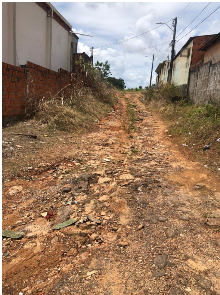
Figura 1 – Necessidade de pavimentação asfáltica
