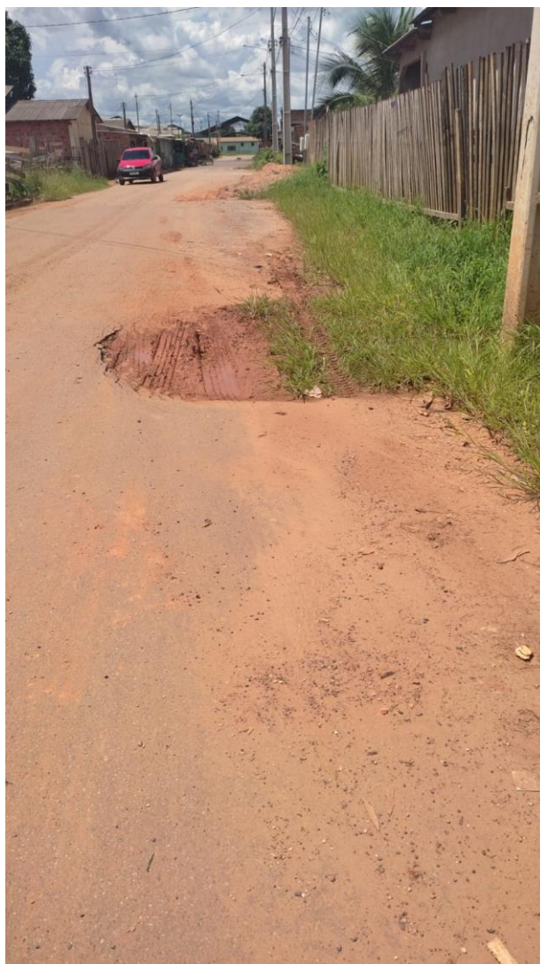
Figura 1 – Depreciação na massa asfáltica.
