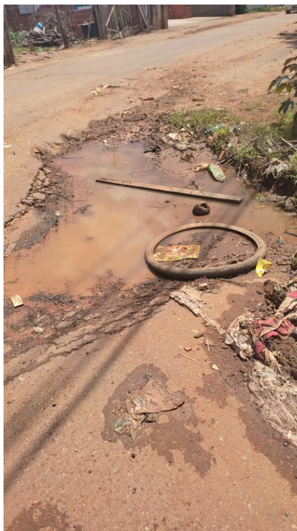
Figura 1 - Rua com Esgoto a céu aberto
