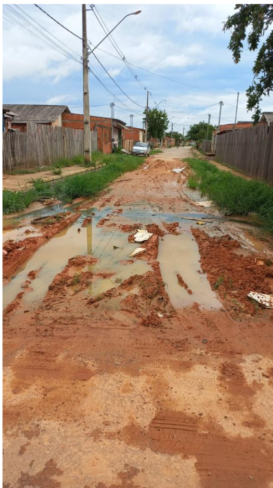
Figura 1 – Necessidade de limpeza, e roçagem.
