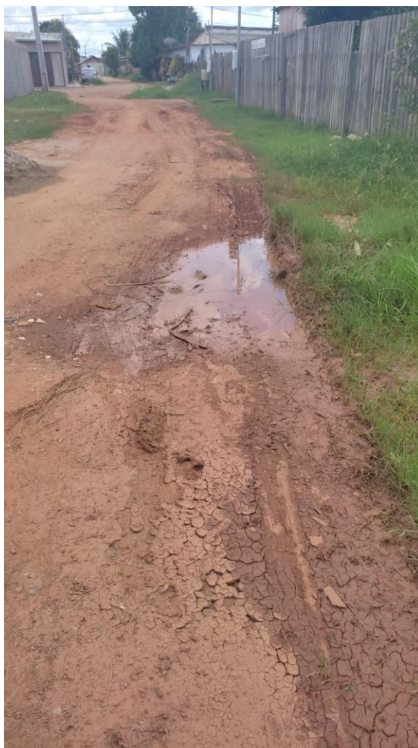
Figura 1 – Rua sem massa asfáltica.
