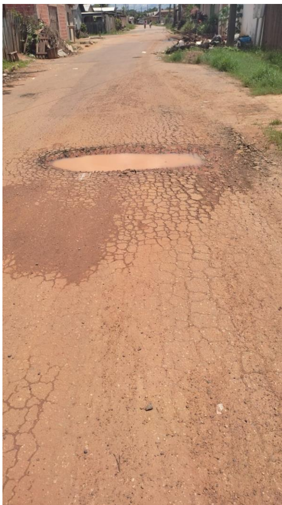
Figura 1 – Depreciação na massa asfáltica.
