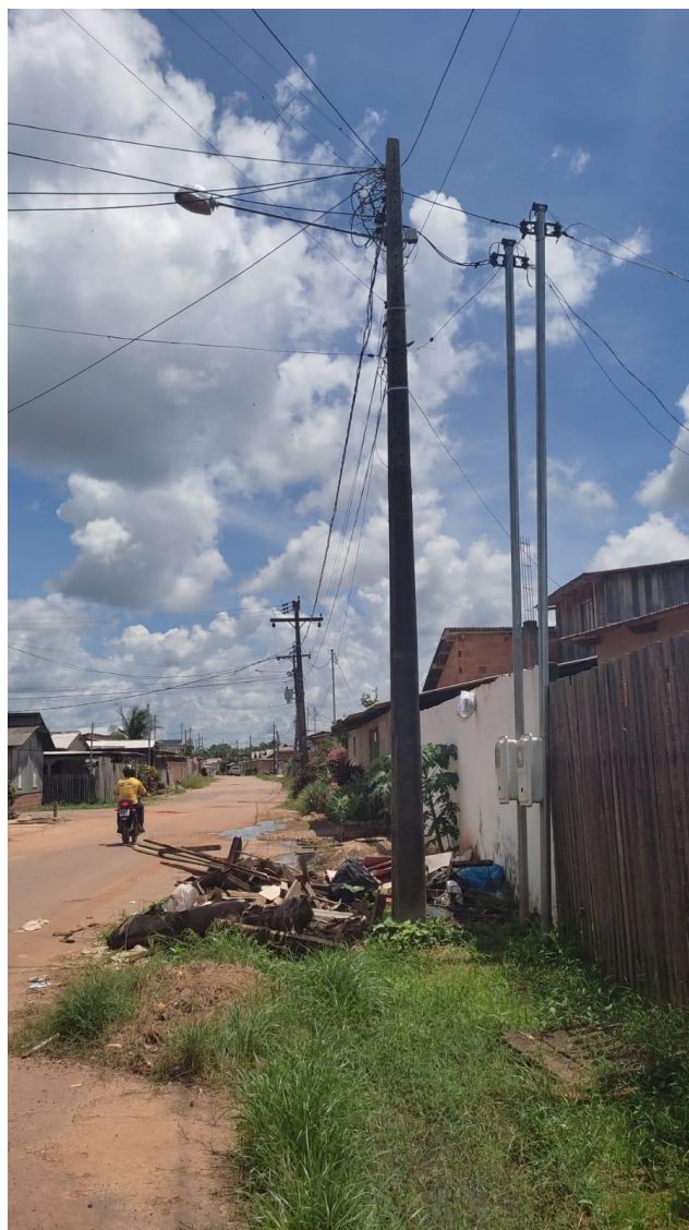
Figura 1 - Necessidade de limpeza e retirada de entulhos
