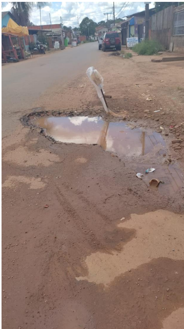
Figura 1 – Depreciação na massa asfáltica.
