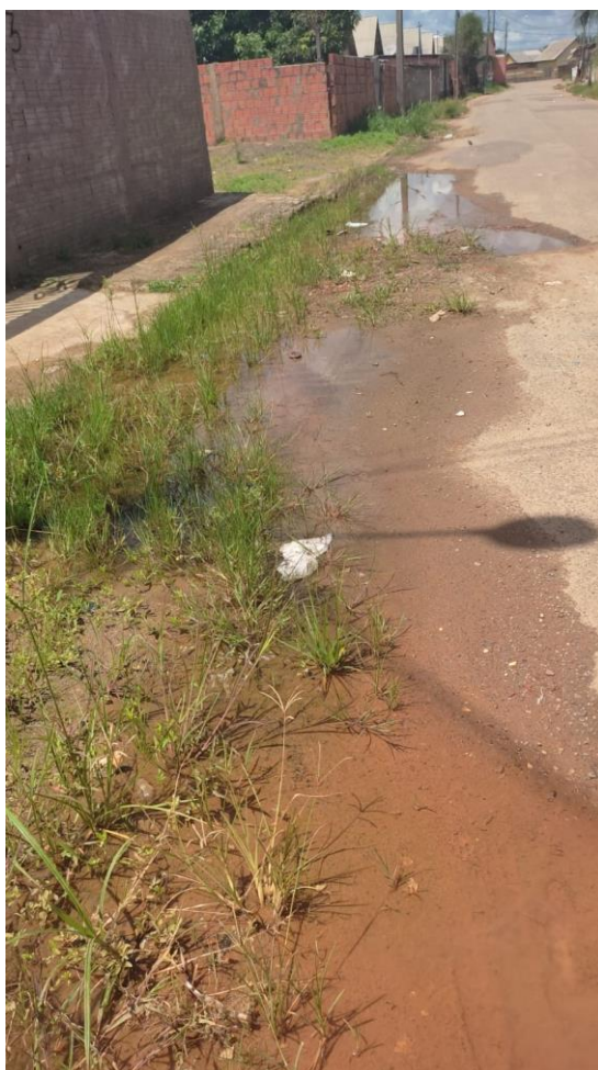
Figura 1 - Rua com Esgoto a céu aberto
