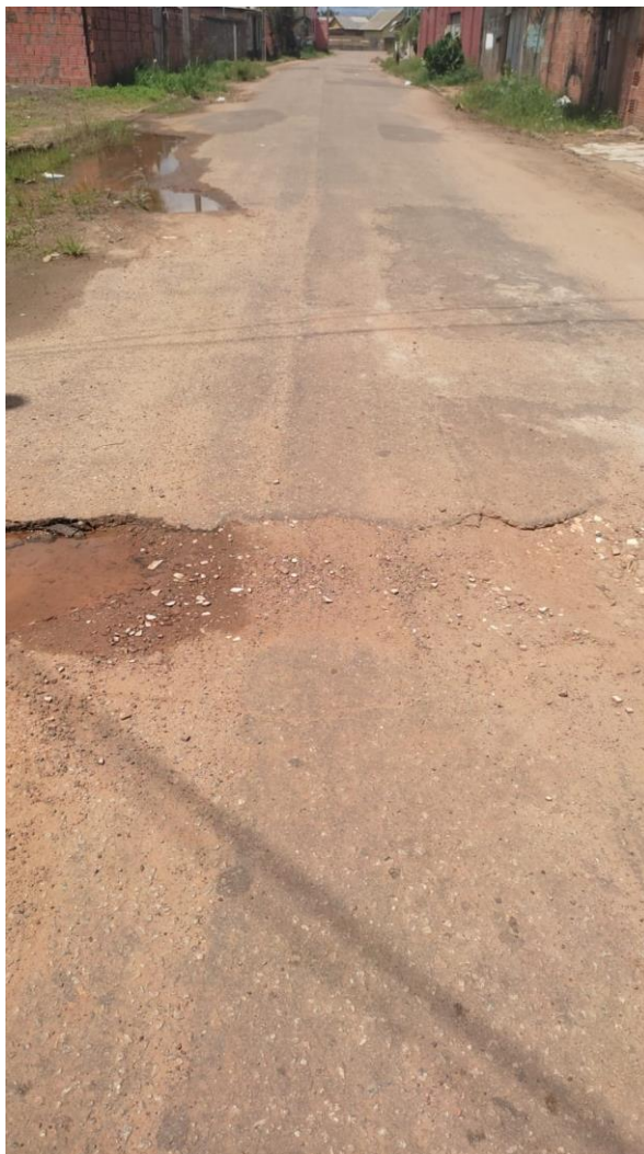
Figura 1 – Depreciação na massa asfáltica.
