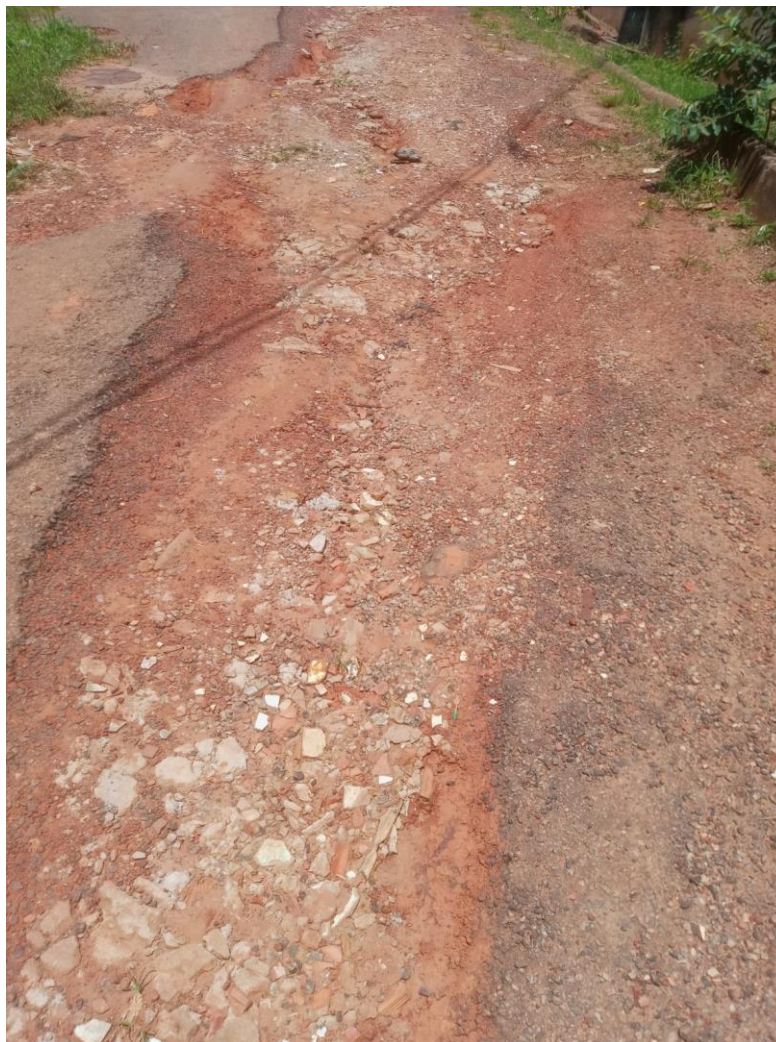
Figura 1 – Necessidade de manutenção na pavimentação.
