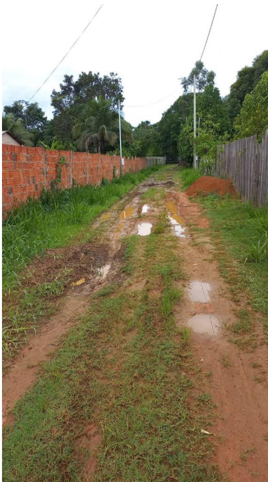
Figura 1 – Travessa sem pavimentação Asfáltica.
