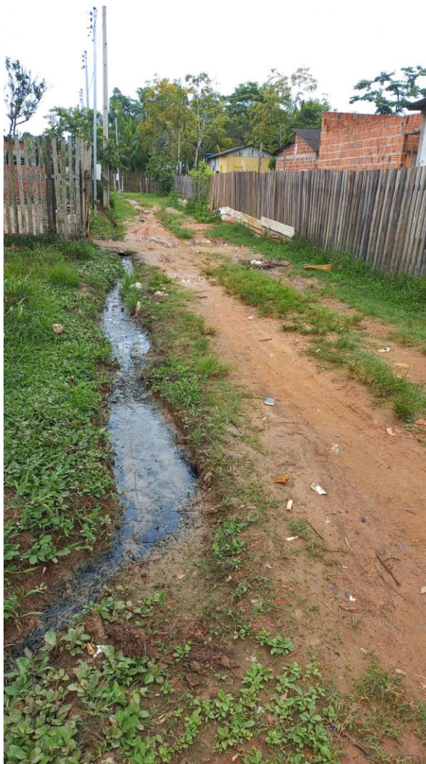
Figura 1 – Travessa sem pavimentação Asfáltica.
