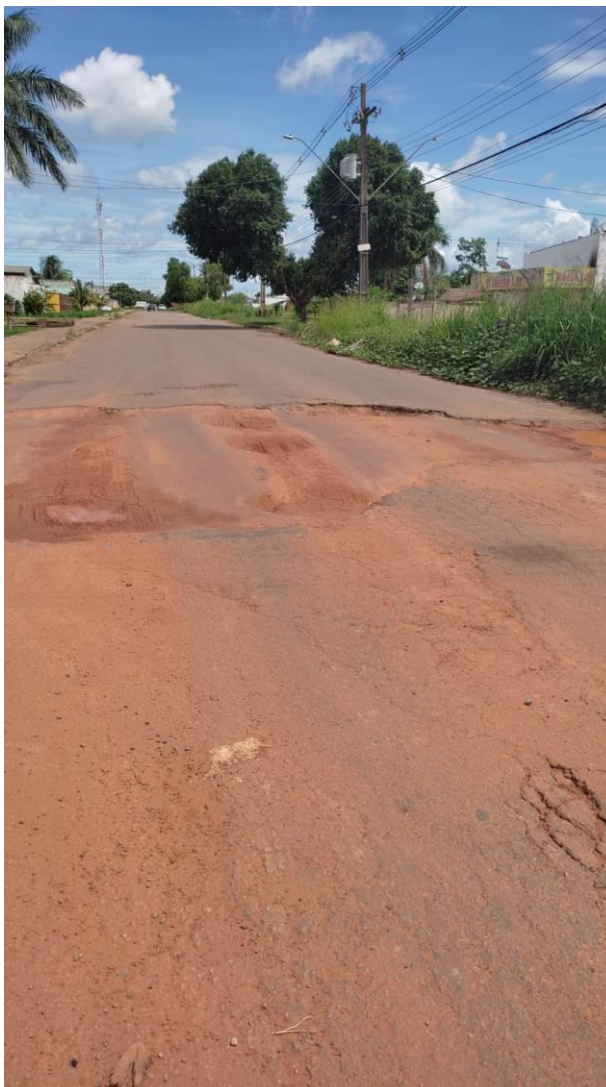
Figura 1 – Rua necessita da manutenção em sua pavimentação
