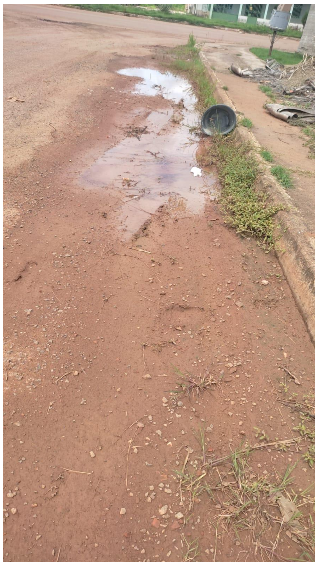
Figura 1 – Rua necessita da manutenção em sua pavimentação
