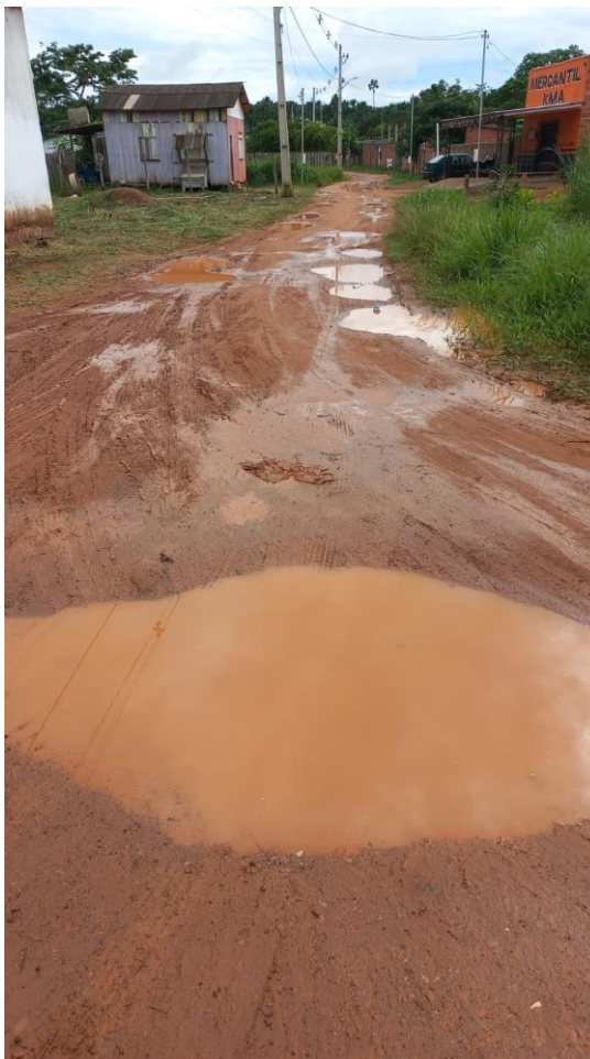
Figura 1 – Rua sem pavimentação.
