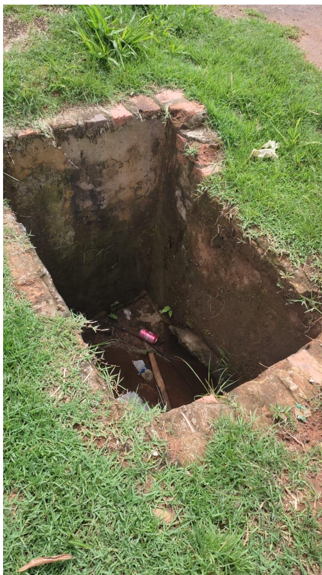
Figura 1 – Necessidade de manutenção na Rede de esgoto.
