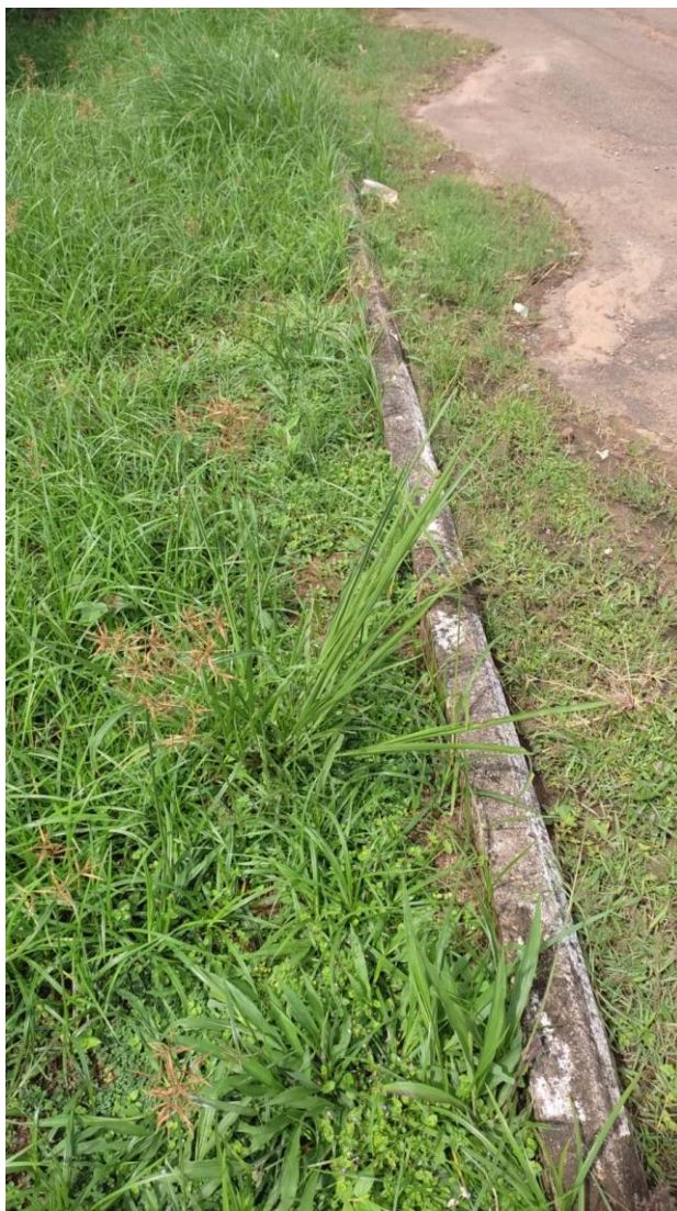
Figura 1 – Rua necessita de limpeza e Roçagem
