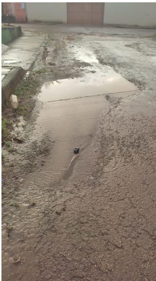
Figura 1 – Rua necessita de Restauração asfáltica
