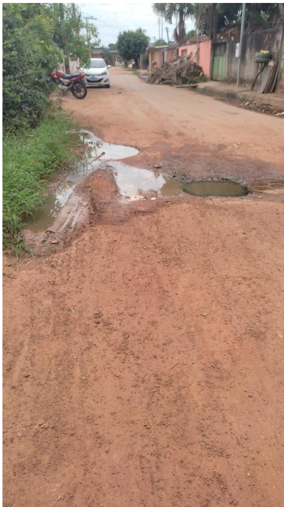
Figura 1 – Travessa necessita de Restauração asfáltica
