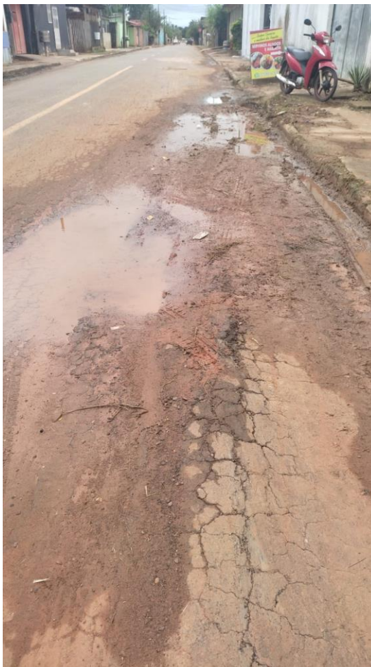
Figura 1 – Rua necessita de Restauração asfáltica
