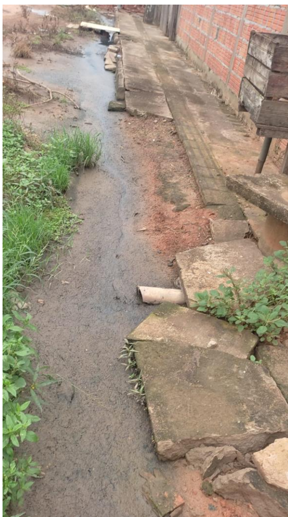
Figura 1 – Necessidade de manutenção na Rede de esgoto.
