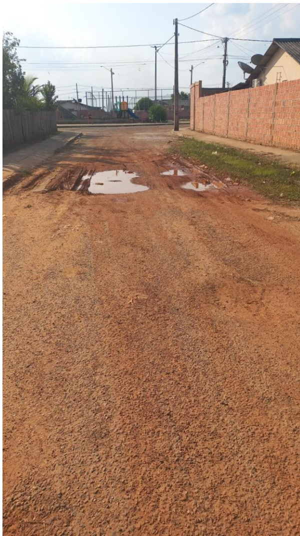
Figura 1 –Rua necessita de Pavimentação asfáltica
