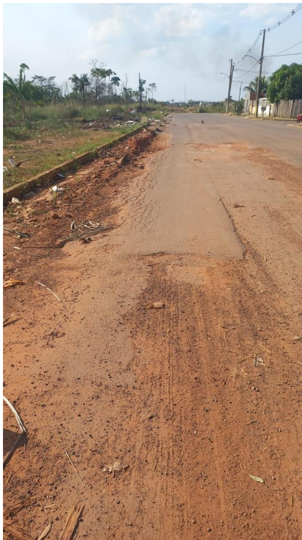
Figura 1 –Rua necessita de Pavimentação asfáltica
