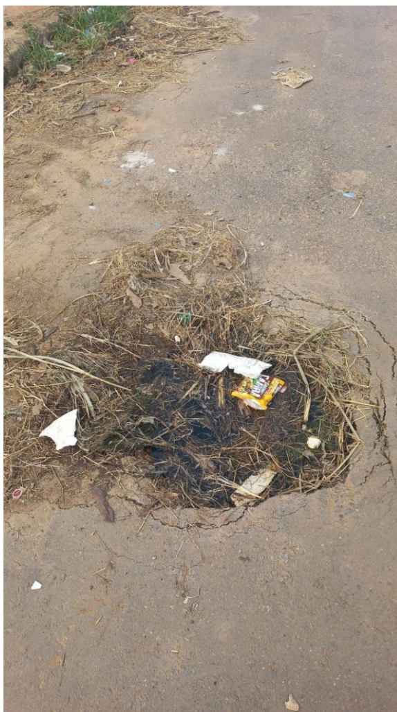
Figura 1 – Necessidade de manutenção na Rede de esgoto.
