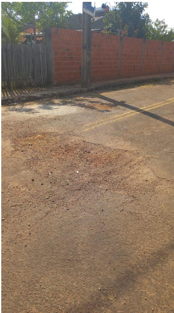
Figura 1 –Rua necessita de Pavimentação asfáltica
