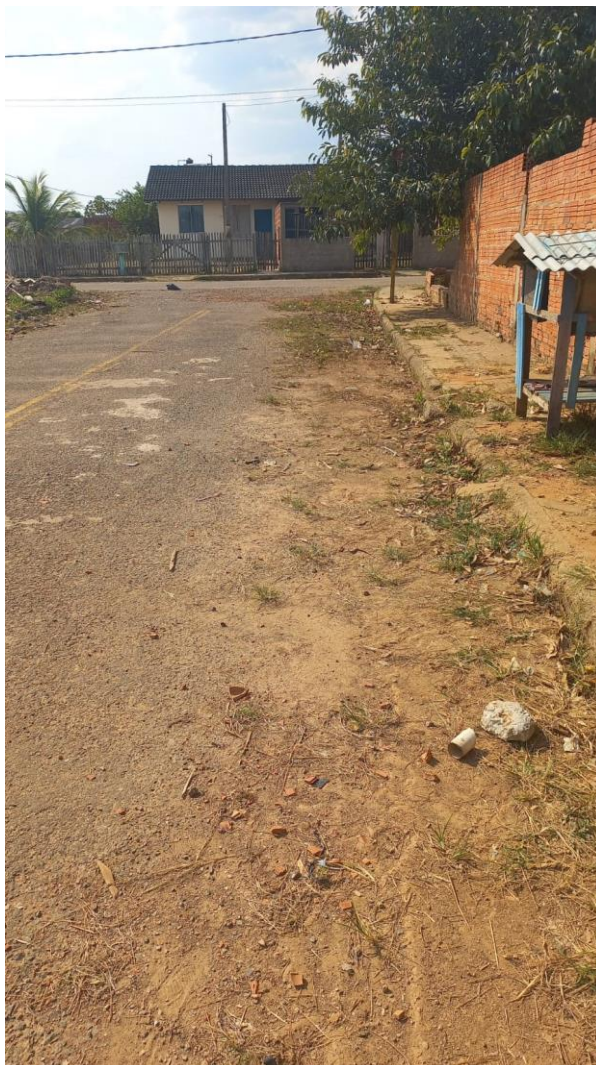
Figura 1 –Rua necessita de Pavimentação asfáltica
