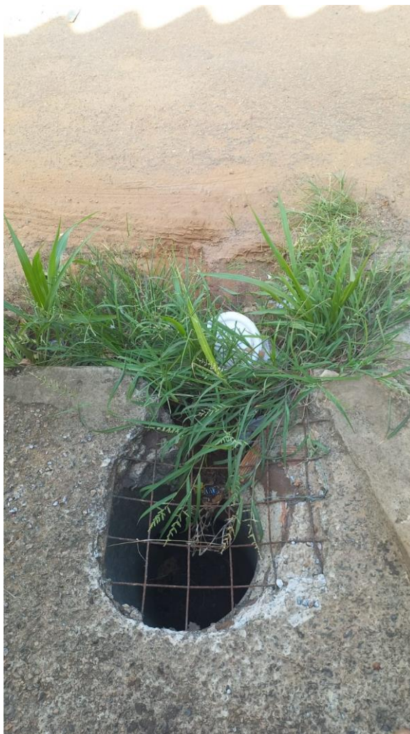
Figura 1 – Necessidade de manutenção na Rede de esgoto.
