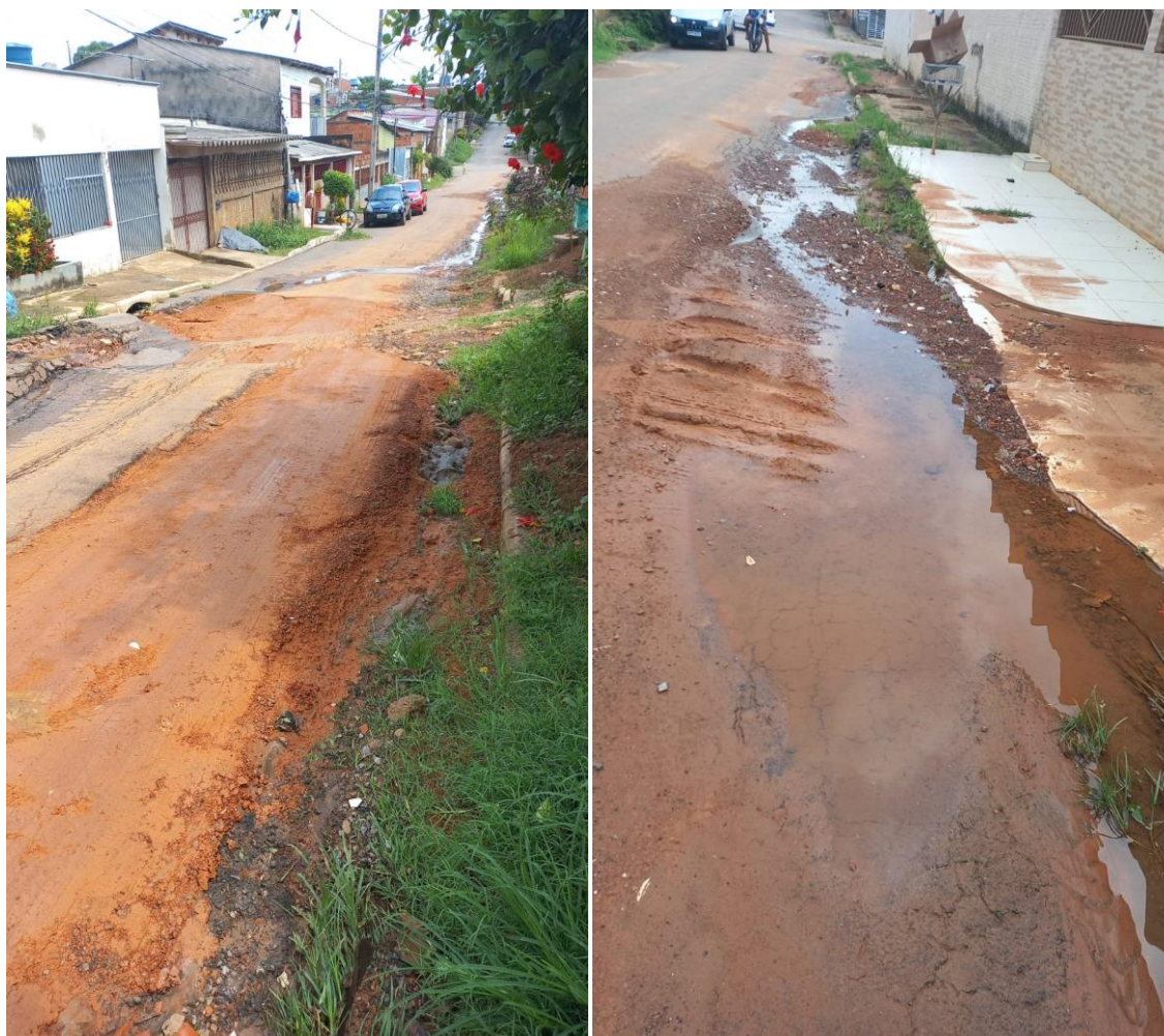
Figura 1 – Rua necessita de Pavimentação asfáltica
