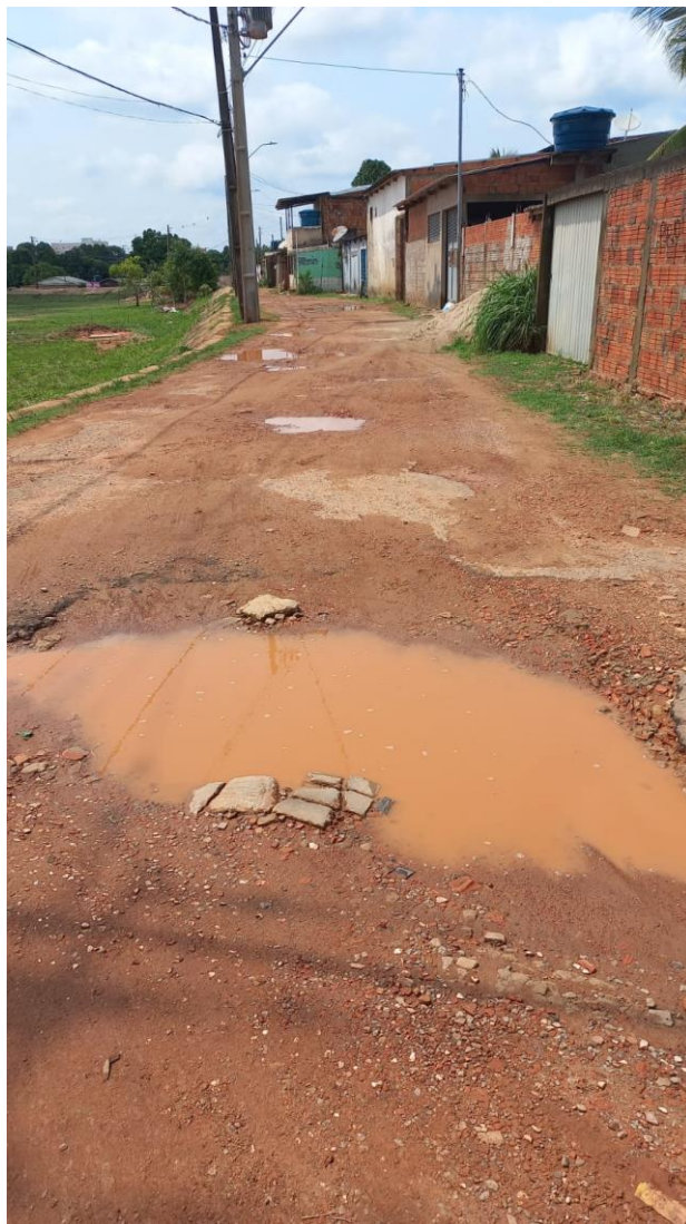
Figura 1 – Rua necessita de Pavimentação asfáltica
