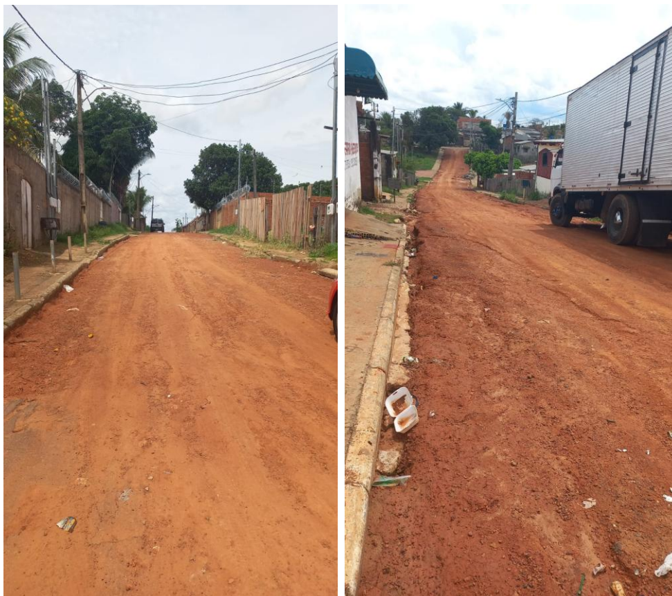
Figura 1–Rua necessita de Pavimentação asfáltica
