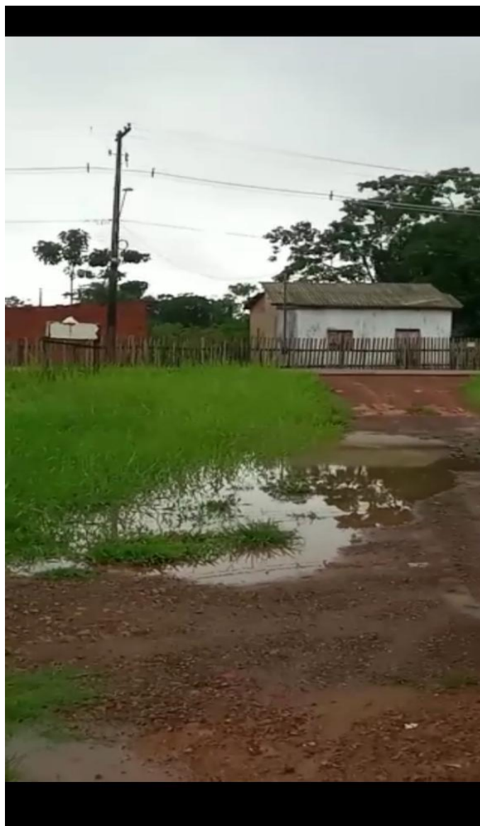
Figura 1–Ramal necessita de Pavimentação asfáltica
