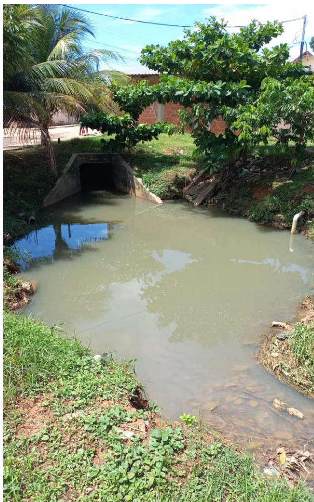
Figura 1 - Necessidade de desobstrução na Rede de esgoto.
