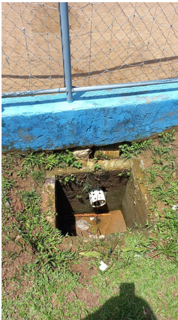
Figura 1 - Necessidade de tampa na Rede de esgoto.
