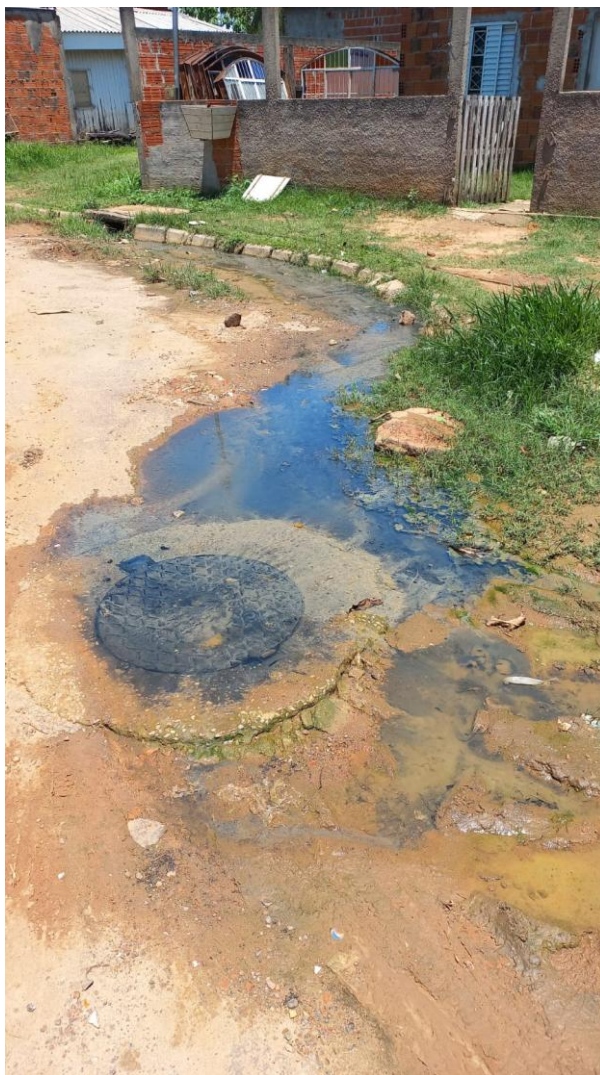
Figura 1 - Necessidade de manutenção na Rede de esgoto.
