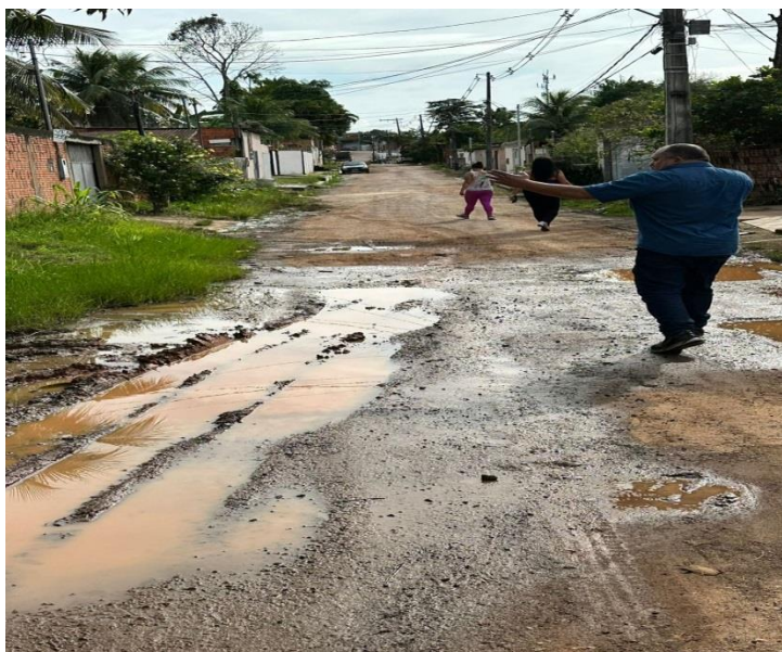
Figura 2 – A rua necessita de pavimentação, criação de sistema de saneamento básico e instalação de bueiros.
