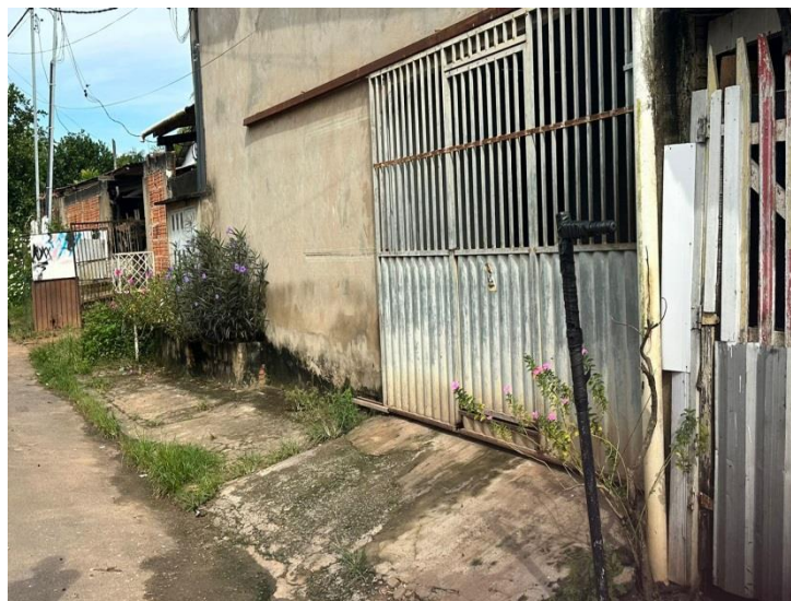
Figura 2 – Faixa de medição até aonde a água atingiu a casa nesta enchente.
