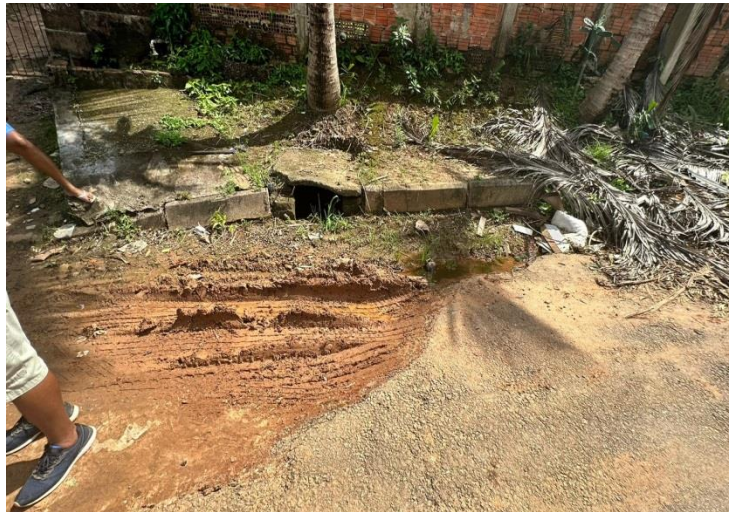
Figura 3– A rua necessita de pavimentação, criação de sistema de saneamento básico e instalação de bueiros.
