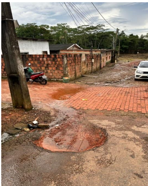
Figura 2 – A rua necessita de pavimentação, criação de sistema de saneamento básico e instalação de bueiros.
