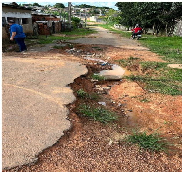
Figura 2 – A rua necessita de pavimentação, criação de sistema de saneamento básico e instalação de bueiros.
