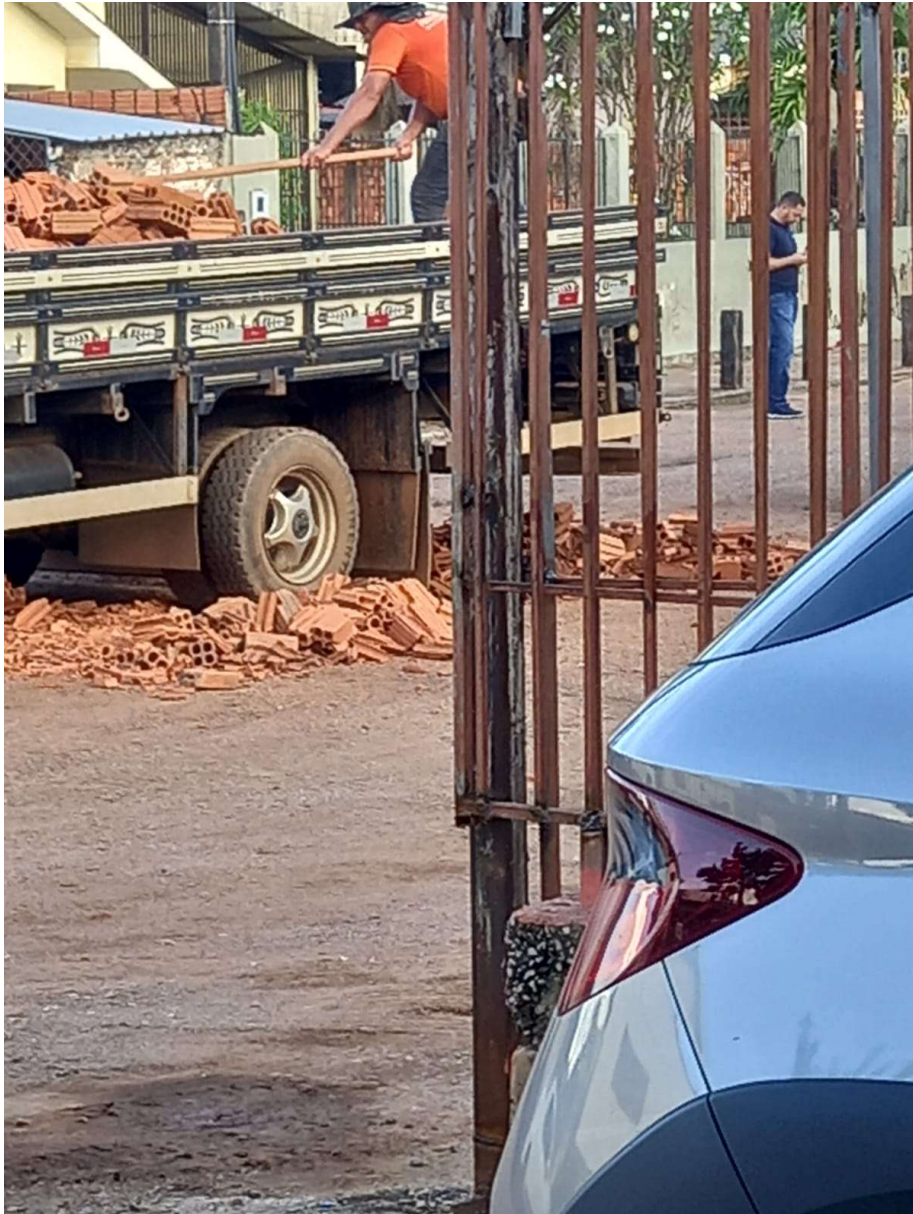
Figura 3 – Moradores tapando os buracos com tijolos.
