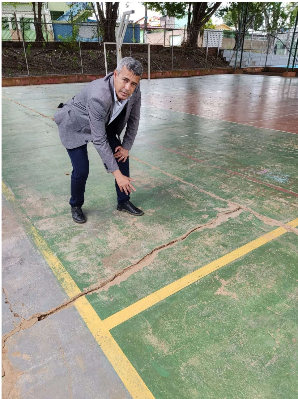
Figura 3 – Rachaduras por todo o piso da quadra.
