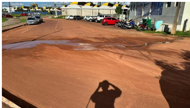
Figura 2 – A alameda necessita de pavimentação, calçamento, passagem externa para pedestres coberta.
