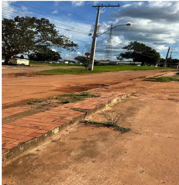
Figura 3– Falta de calçamento para os pedestres.
